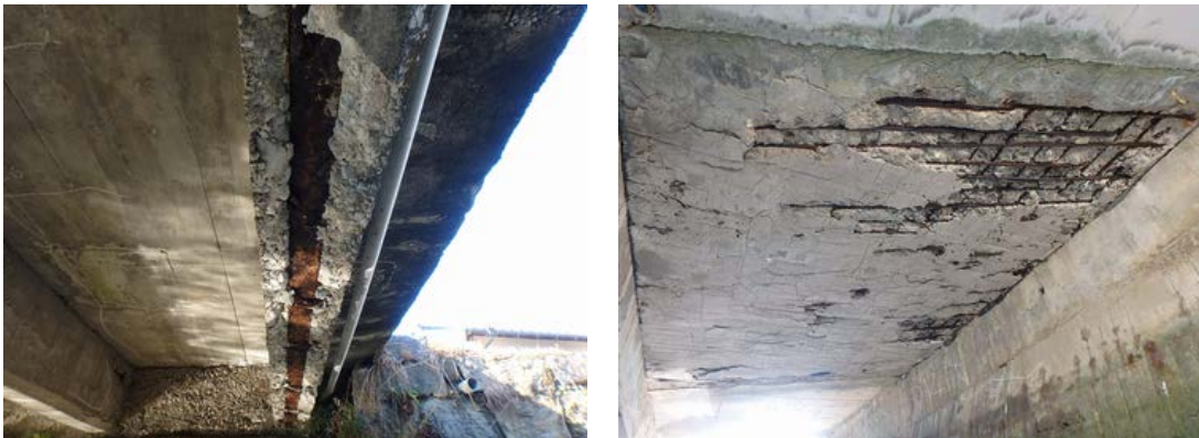
図 1.2.3 主な損傷事例
