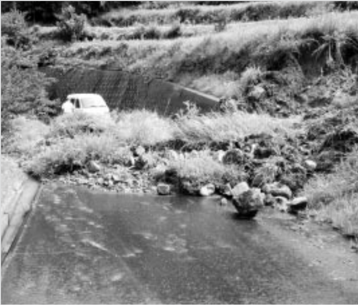
△道路を寸断した土砂災害
