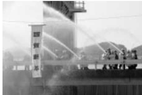
△大内川排水機場での一斉放水
