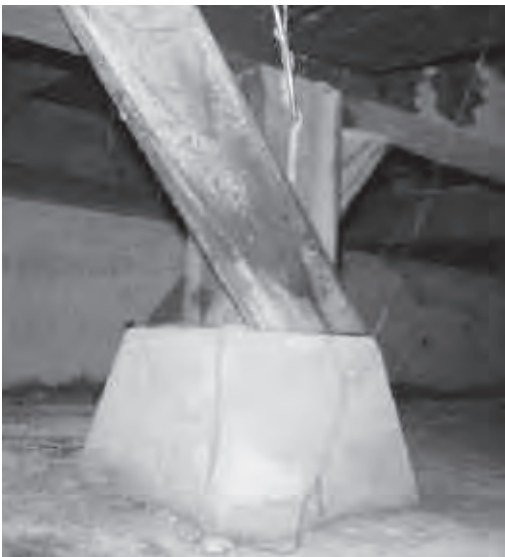
シロアリの被害を受けた床下
