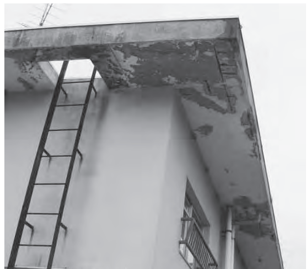
軒下の補修が必要な町営住宅
