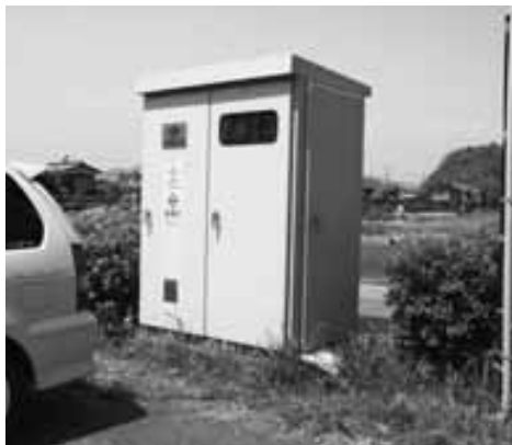
平生中学校キュービクル（受電設備）
