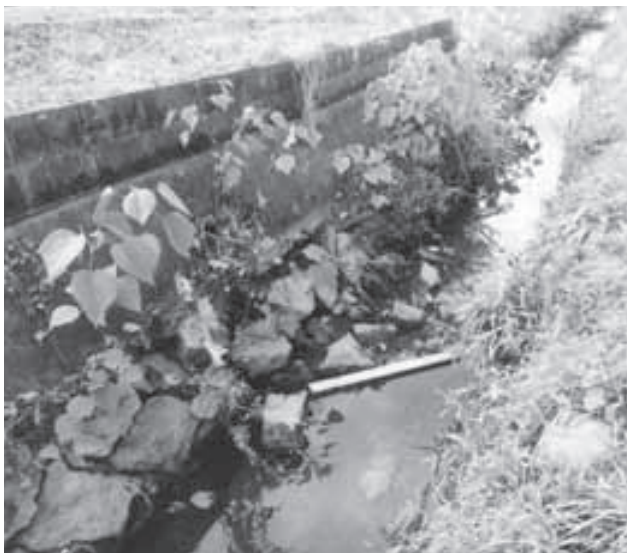
側面の劣化した水路 (大野水越)
