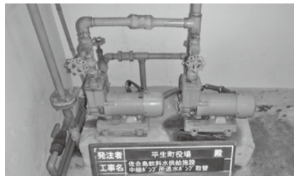
交換前の中継ポンプ(佐合島)
