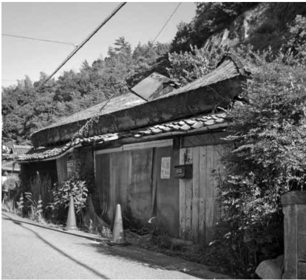
危険な空き家
