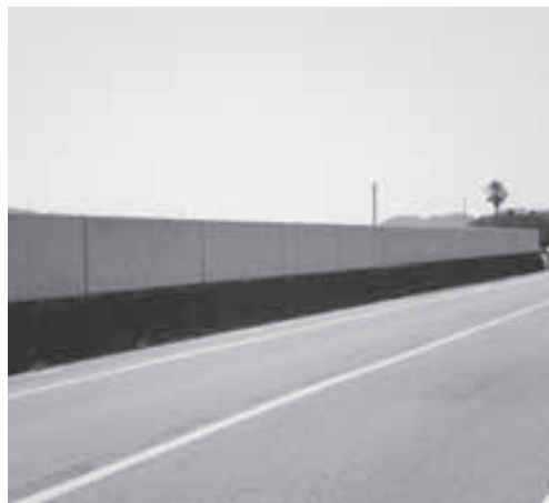
丸山海浜パーク付近の高くなった防潮堤
