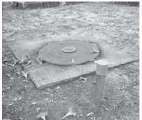
老朽化した防火水槽
