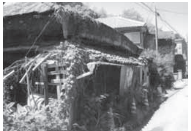
6月15日に倒壊し一時車通行不可
