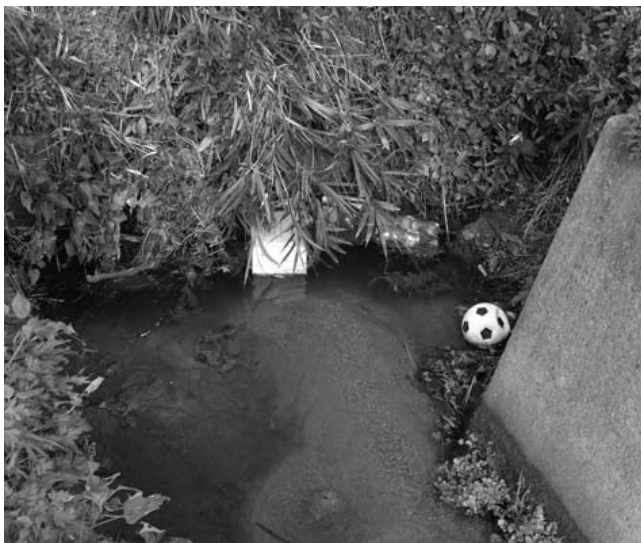
土砂の堆積した天上川の水路
