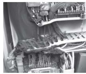
落雷で焼けた設備
