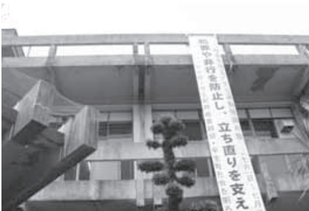
築53年の老朽庁舎
