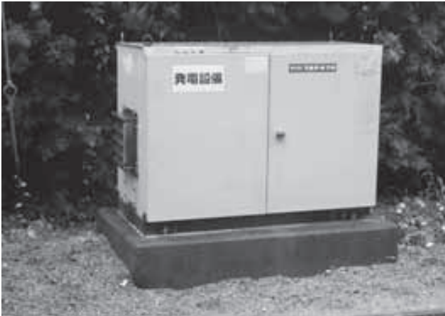
庁舎に3基ある非常用発電機
