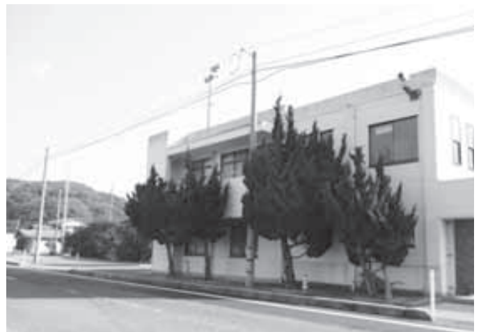
老朽化が進む尾国コミュニティセンター
