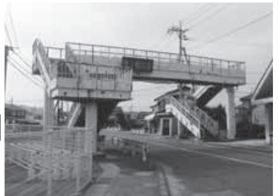
老朽化している平生小学校前の歩道橋
