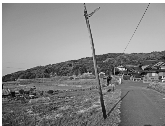
倒れかけた木製電柱
