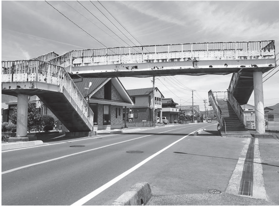
老朽化が激しい平生小学校前歩道橋
