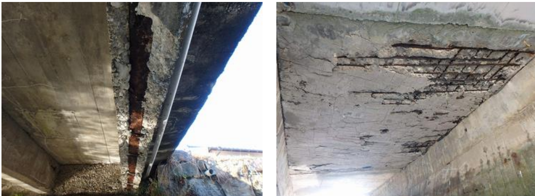
図 1.2.3 主な損傷事例
