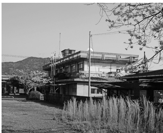
老朽化した庁舎
