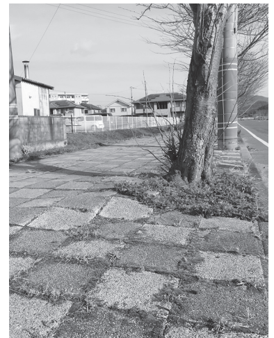
町道桜町線の歩道の凸凹
