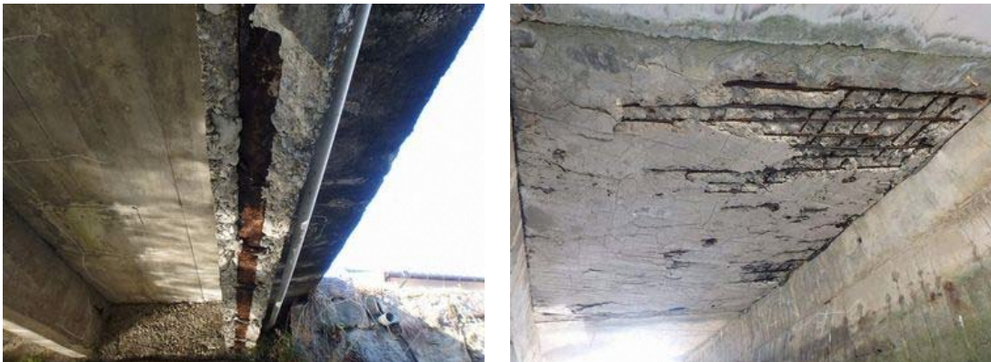
図 1.2.3 主な損傷事例
